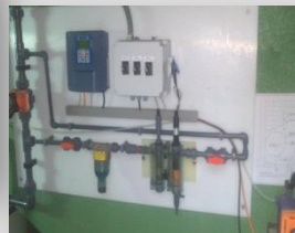
SISTEMAS CLORACIÓN AGUA POTABLE
