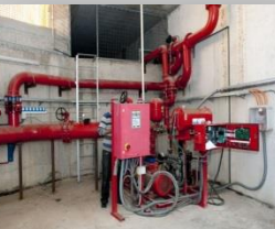
GRUPO PRESIÓN INCENDIOS
